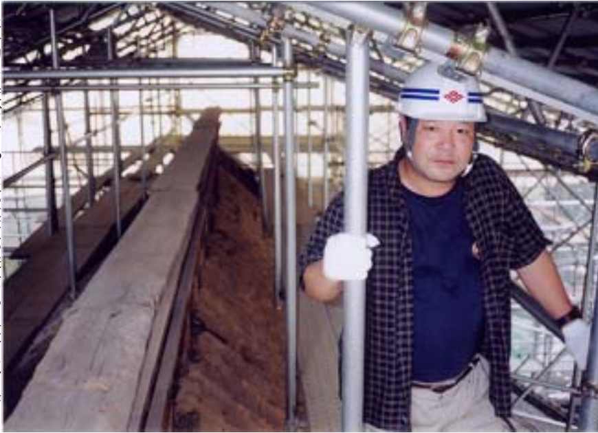
本格的に工事が始まった本堂修復の様子。写真は、瓦を降ろした屋根の最上部(棟)に立つ南法務員。立つてみるとかなりの急傾斜です。
